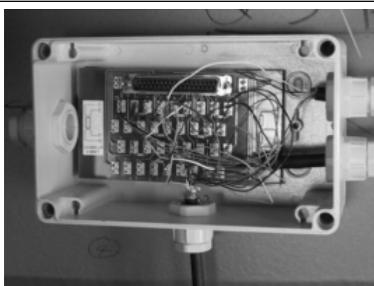
Bild 10: Bündelung der Messstellenleiter
